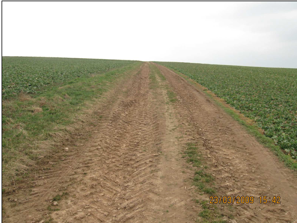
Bild 6: Erosionsschäden am Weg Nr. 129.1
