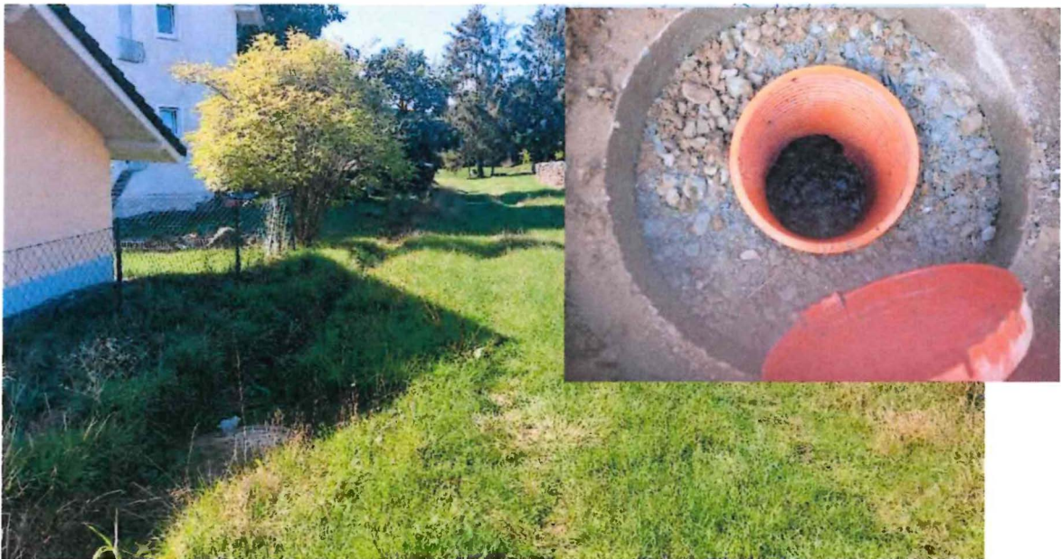
Abb. 9: Weg 114, Vorhandener Drainageschacht bei Garage Haus Nr. 6 mit Blickrichtung nach Westen
